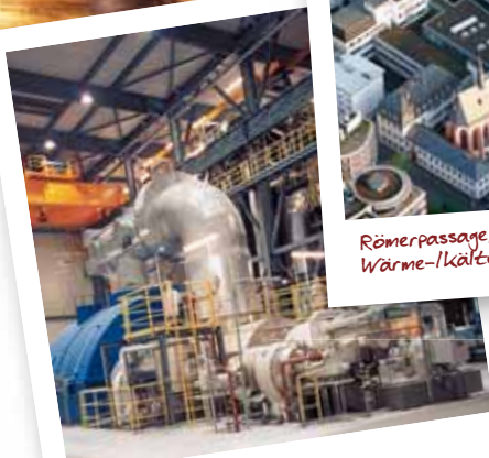
Ingelheimer Aue, Mainz Effizientes Gas- und Dampfkraftwerk
